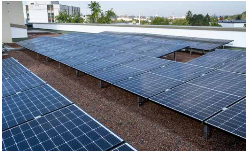
Photovoltaikanlage auf dem Dach des International Graduate Centre for the Study of Culture (GCSC)
