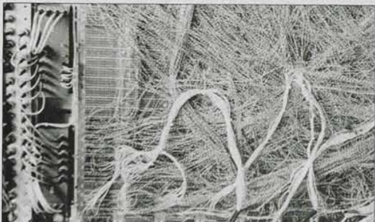
Strippensalat: Welche Dimensionen das Rechenzentrum im Jahr 1980 bereits hatte, verdeutlichen die zehntausende Meter von Datenkabeln. Bild: Archiv
